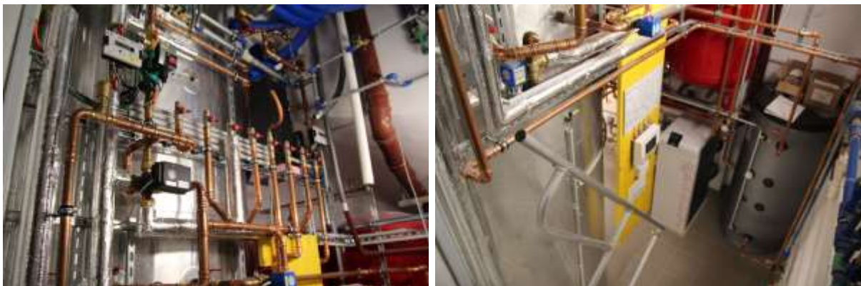
Abbildung 136: Technikraum des Solarhauses Lindemberger (Quelle: AIT)
