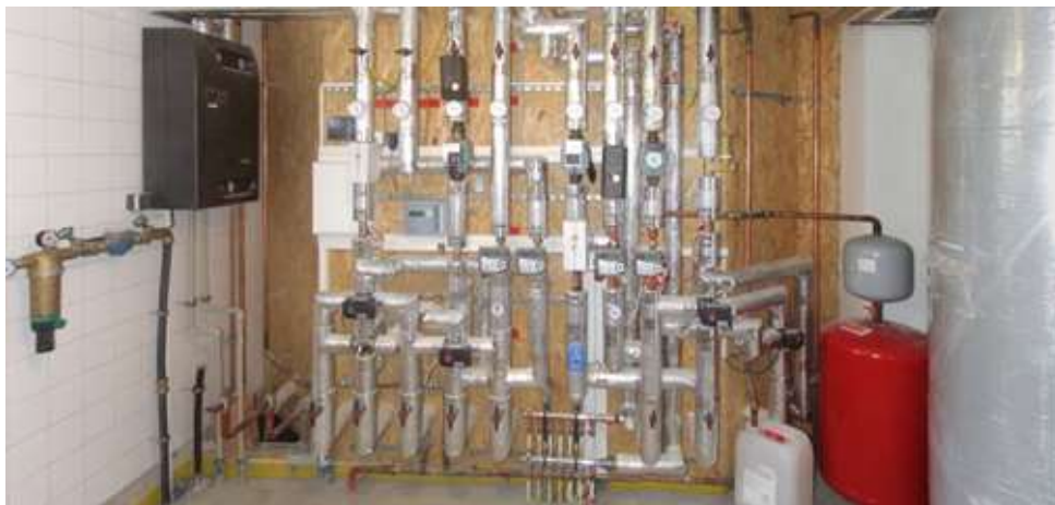
Abbildung 77: Technikraum des Solarhauses Wieder (Bildquelle: AEE INTEC)
