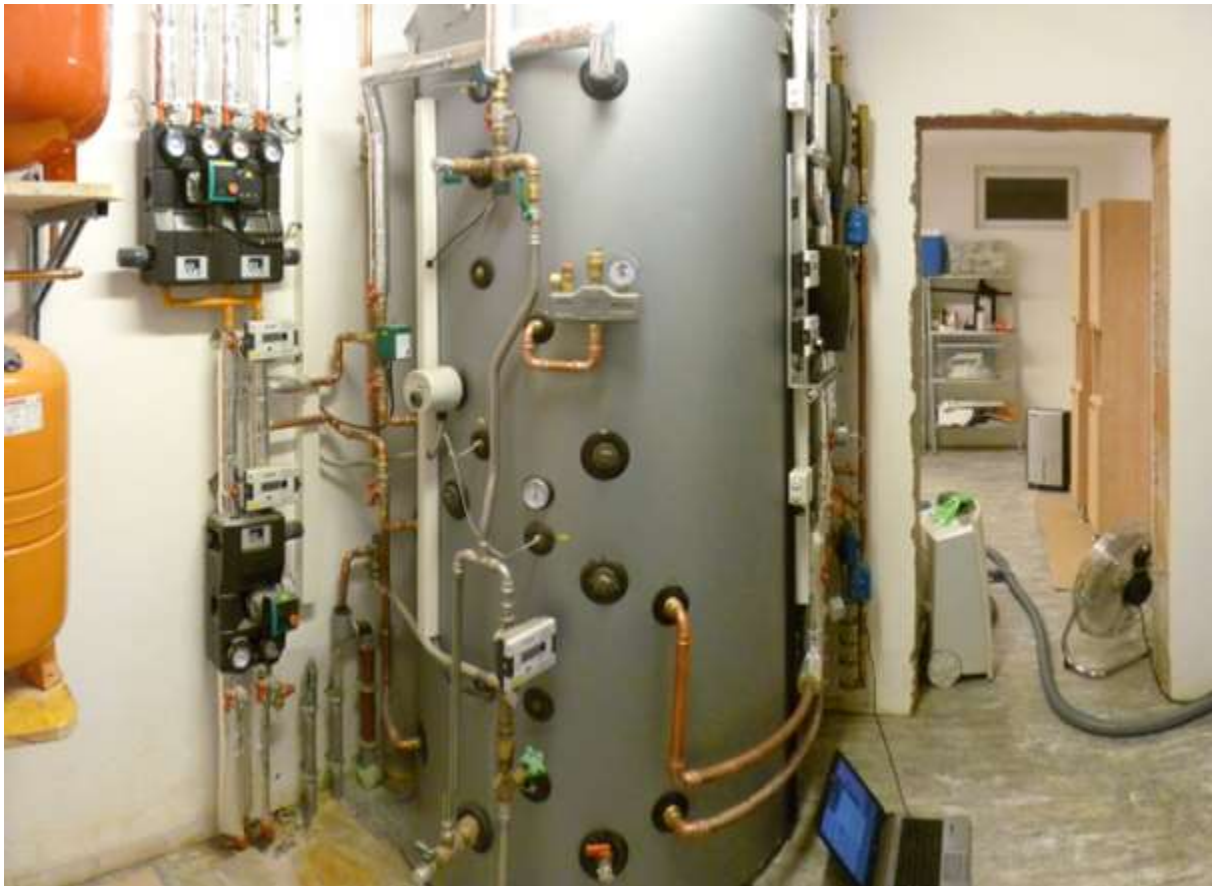
Abbildung 116: Technikraum mit Pufferspeicher samt hydraulischen Aufbauten (Quelle: AEE INTEC)
