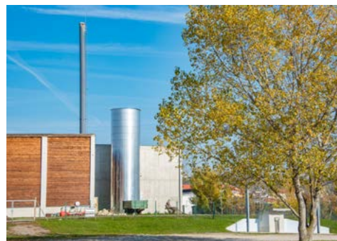
▲ Heizzentrale Neusiedl am See, Foto: Energie Burgenland
