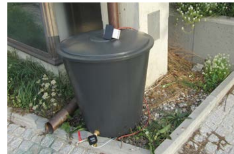
▲▲ Foto oben: Messtechnik für die urbane Wasserinfrastruktur
