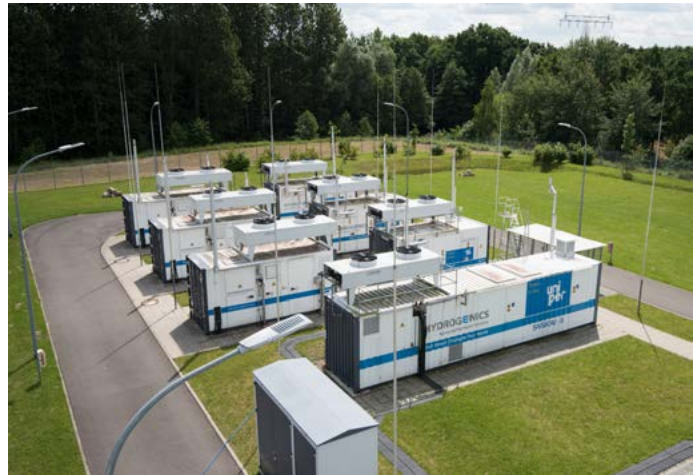
Elektrolyseanlage, Foto: Uniper Energy Storage GmbH
