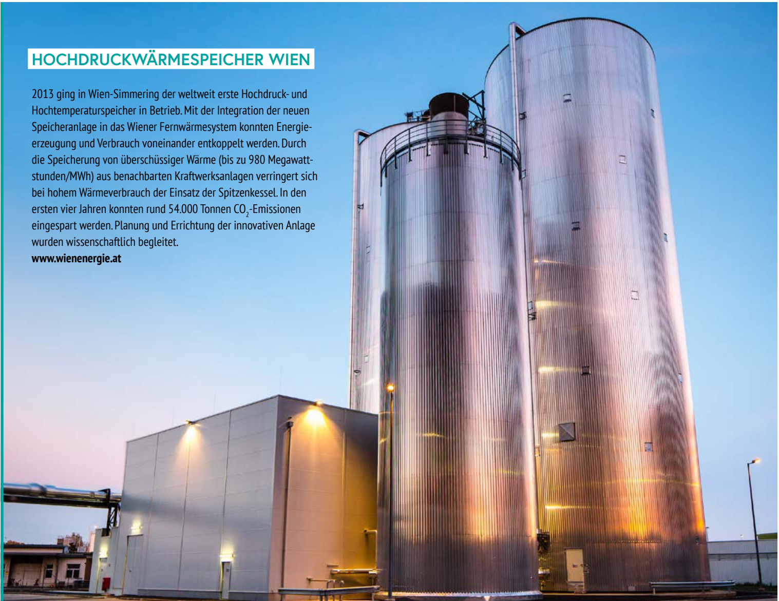
Foto: Wien Energie/Ian Ehm
