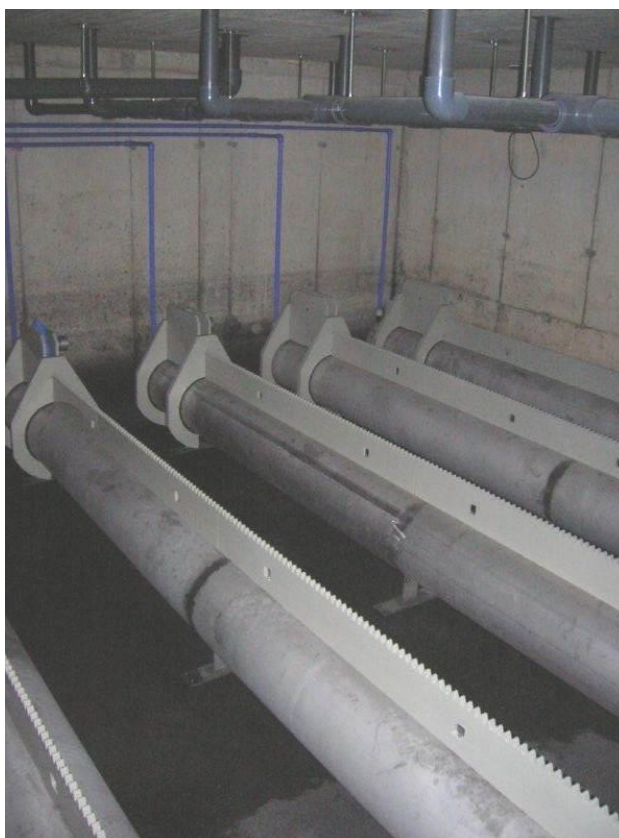
Abbildung 7: Abwasser-Wärmerückgewinnung im Rückhaltebecken der Wellnessoase Hummelhof (Quelle: Dieter Klammer)
