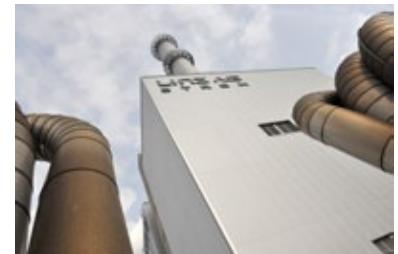
▲ Das Fernwärmesystem von Linz (v.o.n.u.: Fernheizkraftwerk Linz-Mitte, Fernwärmeleitung, zweite Kraftwerkslinie im Fernheizkraftwerk Linz-Mitte) soll in Zukunft noch effektiver gestaltet werden. Alle Fotos: Linz AG
