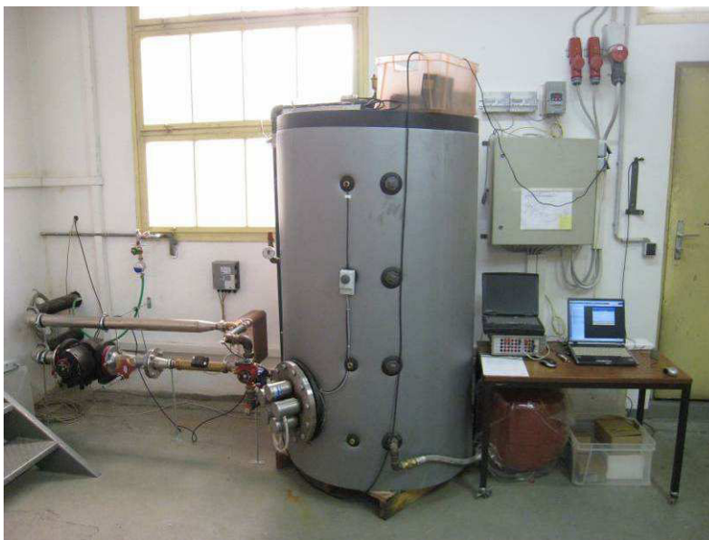
Abbildung 26: Teststandkomponenten im frostsicheren Gebäude
