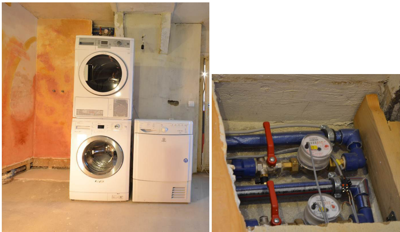
Abbildung 91: Links: Badbereich mit elektrischem Trockner, Waschmaschine, thermischem Trockner (v.l.o.); rechts: Anschlussleitungen mit Mengenzähler
