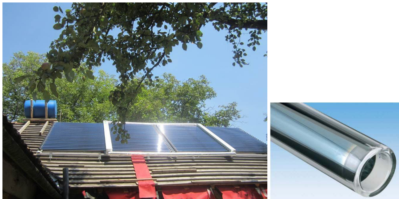
Abbildung 87: links: Solarkollektoren für das Prototypensystem auf der Südseite des Daches in Böheimkirchen; rechts: Aschoff-Vakuumröhre
