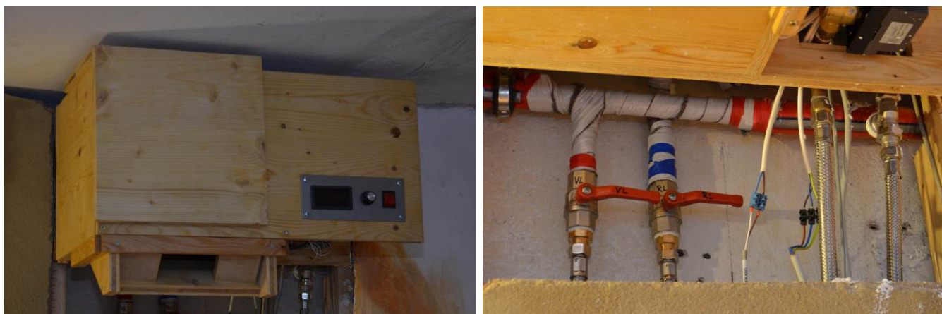
Abbildung 93: Thermischer Haartrockner, konstruiert von GrAT; rechts: Zu- und Ableitungen
