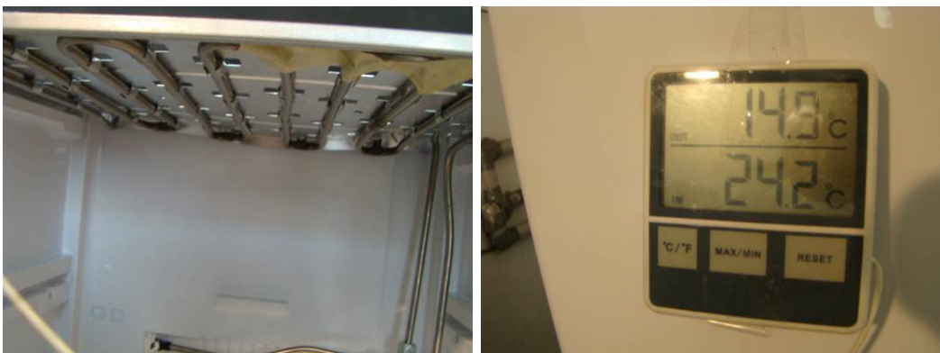
Abbildung 45: Links: Serpentinrohrwärmetauscher im Eudora-Kühlschrank; rechts: Der Serpentinrohrwärmetauscher des Verdampfers im Eudora-Kühlschrank war für Propangas als Kältemittel ausgelegt und funktionierte mit Ammoniak nur sehr schlecht. Die tiefste erreichbare Temperatur betrug 15 °C.
