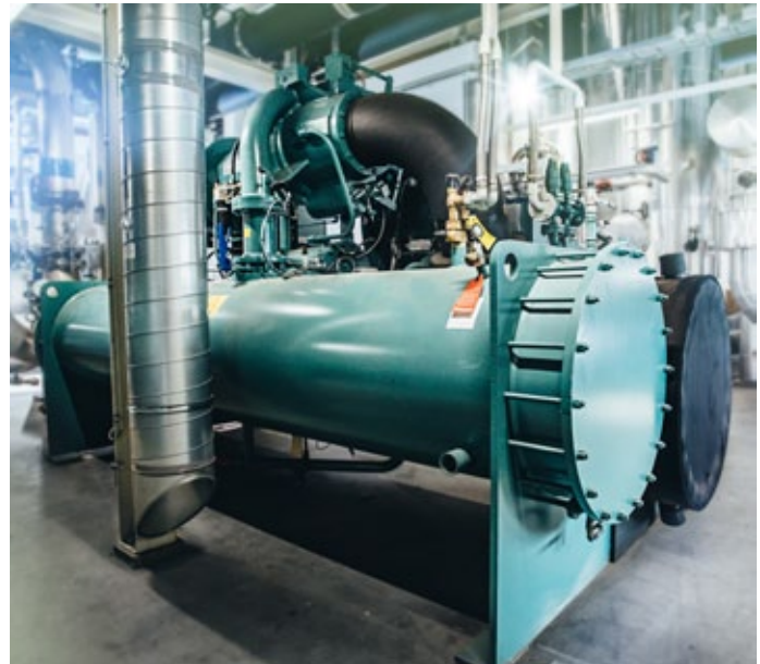
Kältemaschine Foto: Infineon Technologies Austria
