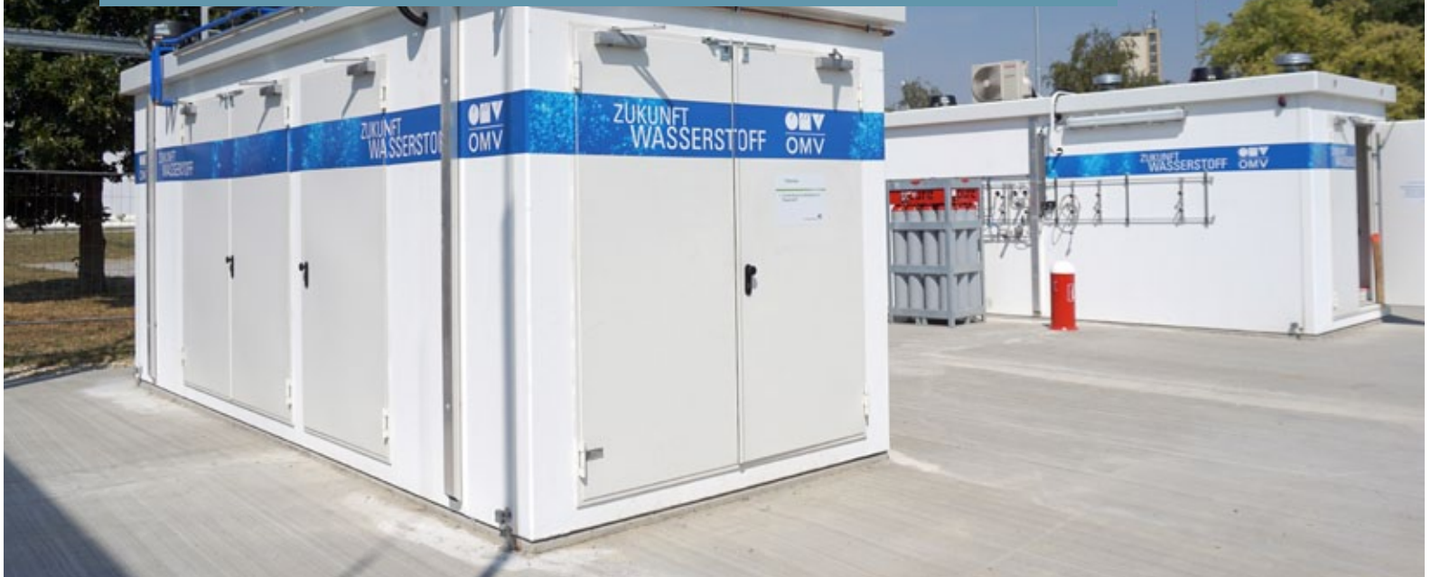
Wind2Hydrogen-Pilotanlage am OMV-Standort Auersthal, Niederösterreich Foto: OMV
