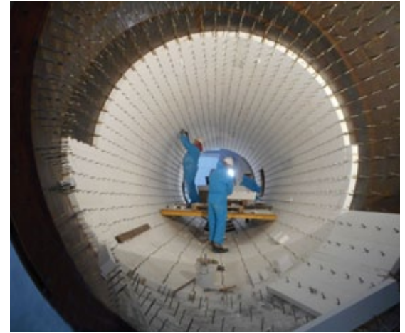
Feuerfestausmauerung der Abluftleitung Foto: voestalpine Stahl GmbH
