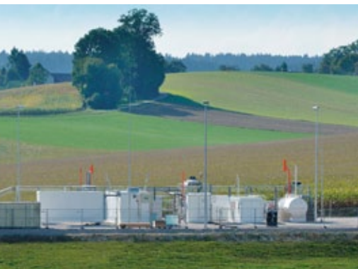
RAG-Anlage in Pilsbach/Oberösterreich Foto: RAG Austria AG
