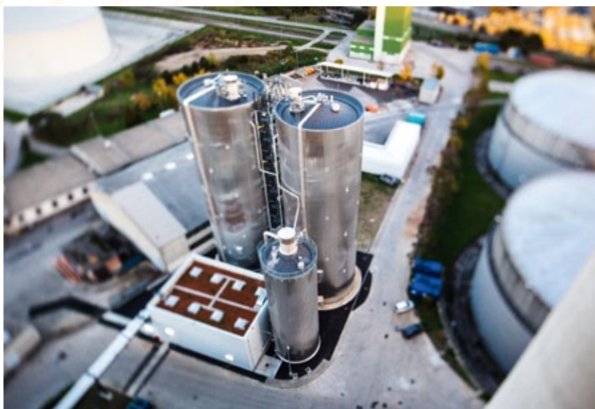
Hochdruck-Wärmespeicher Kraftwerk Simmering Foto: Wien Energie/Ian Ehm
