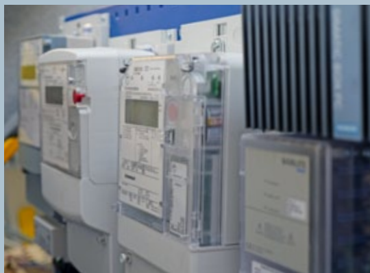
Smart Meter Prüfstand, AIT SmartEST Labor Alle Fotos: Nick Waldhör/Projektfabrik
