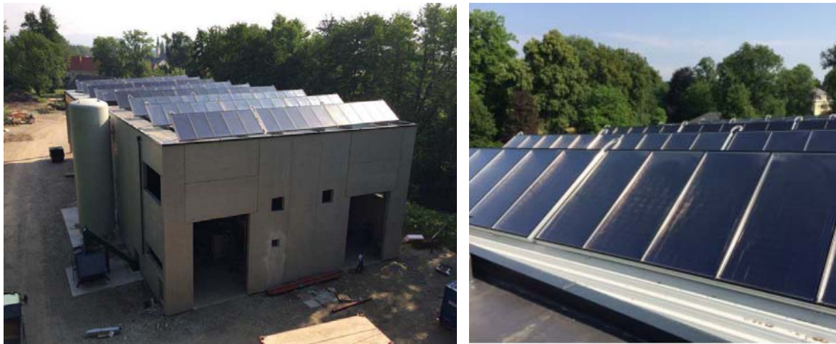
Abbildung 12: Ansicht des Regionalwärme Ebenthal mit den aufgeständerten Kollektoren am Dach des Heizhauses (Quelle: QM-Baubericht, BC Regionalwärme Ebenthal)
