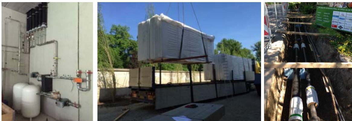
Abbildung 14: Darstellung der Solarkreiswärmetauscher inkl. Ausdehnungsgefäße (linke Darstellung, Quelle: BC Regionalwärme Ebenthal, Ingenieurbüro für erneuerbare Energie), Anlieferung der Solarkollektoren im Zuge der Errichtung (mittlere Darstellung, Quelle: BC Regionalwärme Ebenthal, Ingenieurbüro für erneuerbare Energie), Fernwärmeleitungsbau mit vorisolierten Kunststoffmantelrohren (Quelle: QM-Baubericht, BC Regionalwärme Ebenthal)
