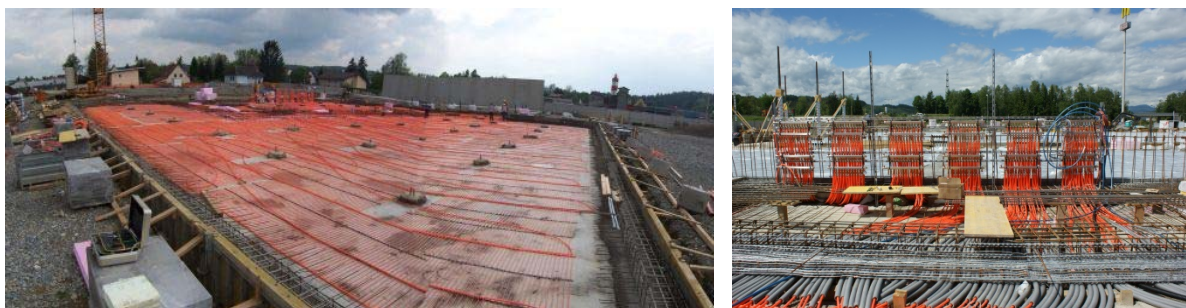
Abbildung 7: Ansicht des Rohregister (links) Verteiler und Verrohrung der Rohrregister für den Erdspeicher (rechtes Bild) im Zuge der Errichtung (Quelle: AEE INTEC)
