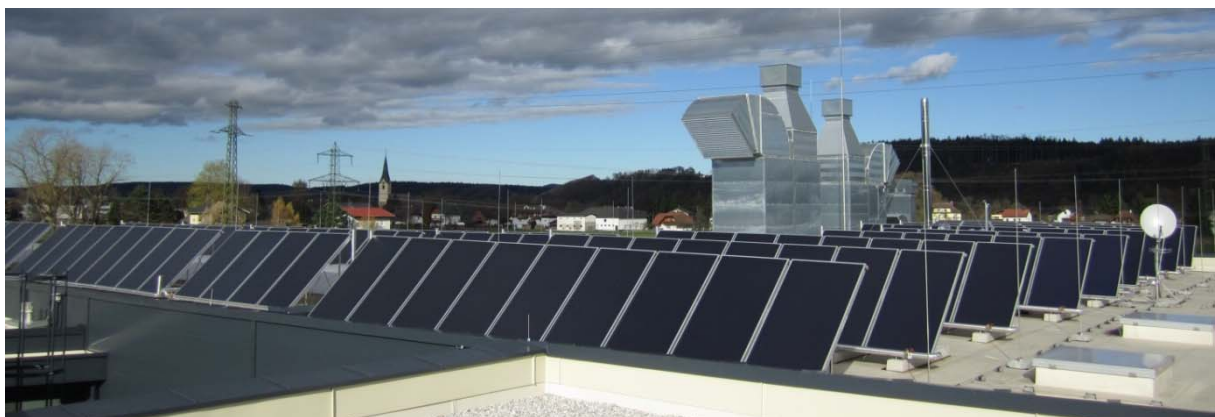
Abbildung 55: Aufständering der Kollektorreihen. Quelle: AIT
