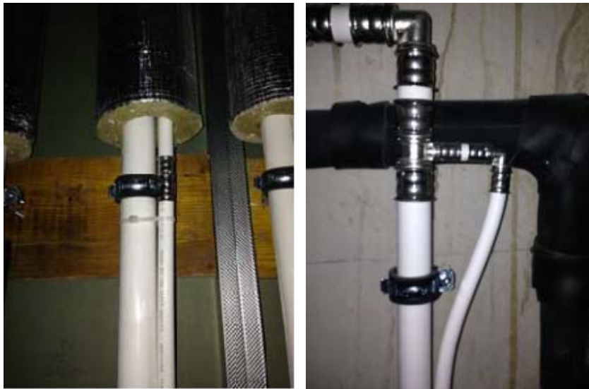
Abbildung 86: Fotos der Vorlaufleitung und der „integrierten Vorlaufzirkulation“ an der Vorlaufleitung (linke Darstellung) und Foto der Einbindung der „Integrierten Vorlaufzirkulation“ am Strangende (Bildquelle: TB Stampfer).
