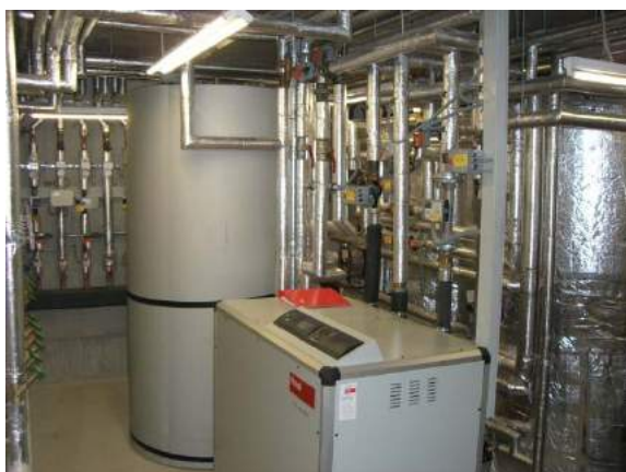
Abbildung 32: Ansicht des Heizraums der Anlage „Brandnertal Gastronomie“. (Bildquelle: Frödd).
