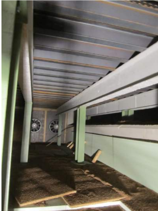
Abbildung 108: Luftverteilschacht unter dem Flachrost mit Ventilatoren (Hintergrund). Quelle: AIT
