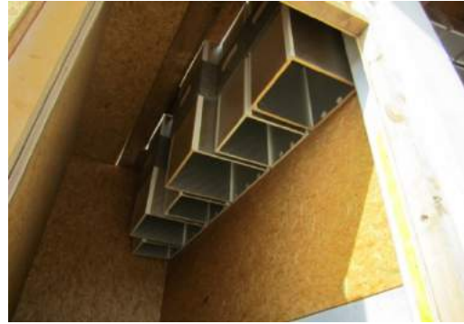
Abbildung 103: Auslassöffnungen der sechs Luftkanäle im Sammelschacht. Quelle: AIT
