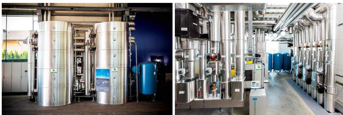
Abbildung 54: Ansicht der beiden Pufferspeicher in der Fassadenbauhalle (linke Darstellung) bzw. Ansicht der Heizzentrale in der „E-Productions Halle“ (Bildquelle: Firma H. Traussnigg GmbH).
