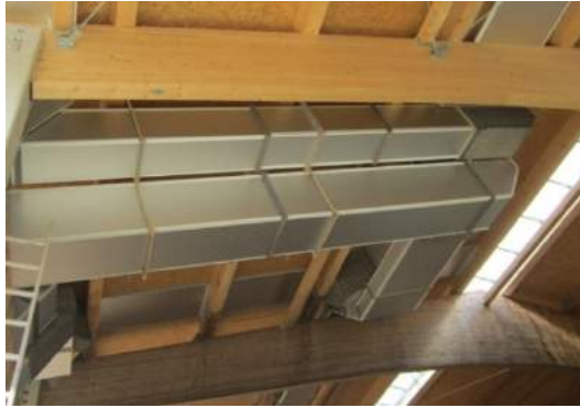
Abbildung 102: Luftkanäle unter der Hallendecke. Quelle: AIT
