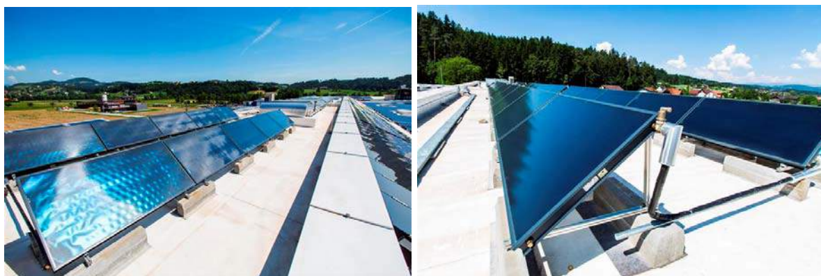
Abbildung 55: Ansicht des Kollektorfelds am Dach des neu errichteten „E-Productions Halle“ (Bildquelle: Firma H. Traussnigg GmbH).
