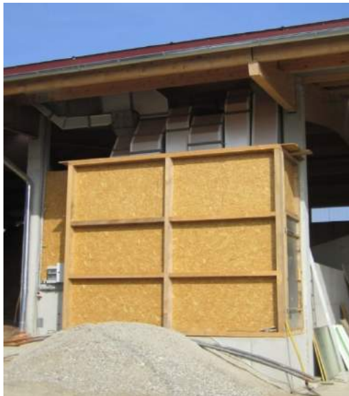
Abbildung 104: Außenansicht des Sammelschachts mit den sechs Luftkanälen (oben), die die Luft von den Kollektoren führen. Quelle: AIT
