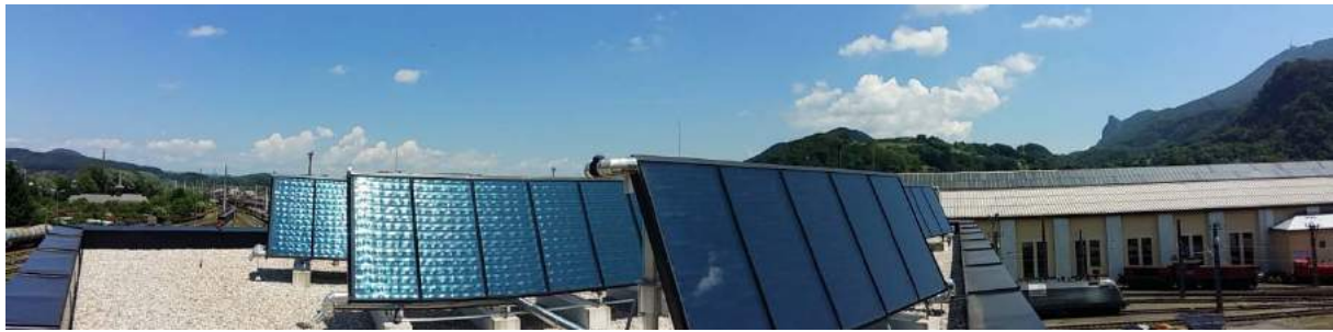
Abbildung 122: Ansicht des Kollektorfeldes am Dach der Lehrwerkstätte (Bildquelle: ÖBB)
