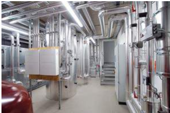
Abbildung 81: Ansicht des Heizraums inkl. der beiden Pufferspeicher des Kultur- und Veranstaltungszentrums Hallwang (Bildquelle: www.kuster.co.at )
