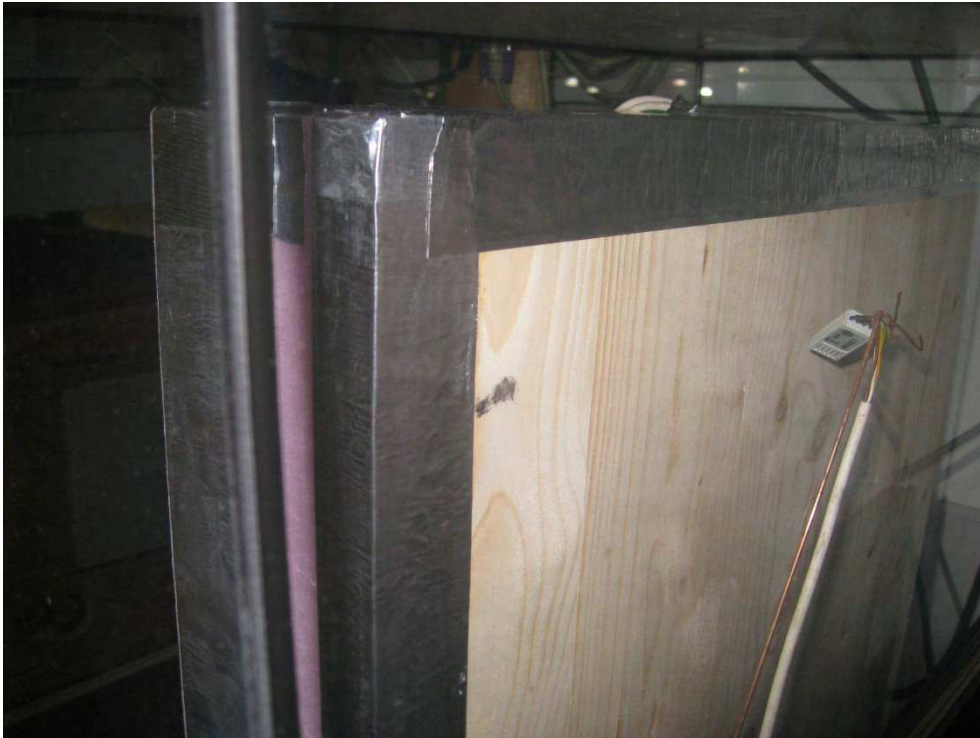
Abbildung 37: Erster Schimmelbefall bei der Schichtholzplatte nach 63 Tagen
