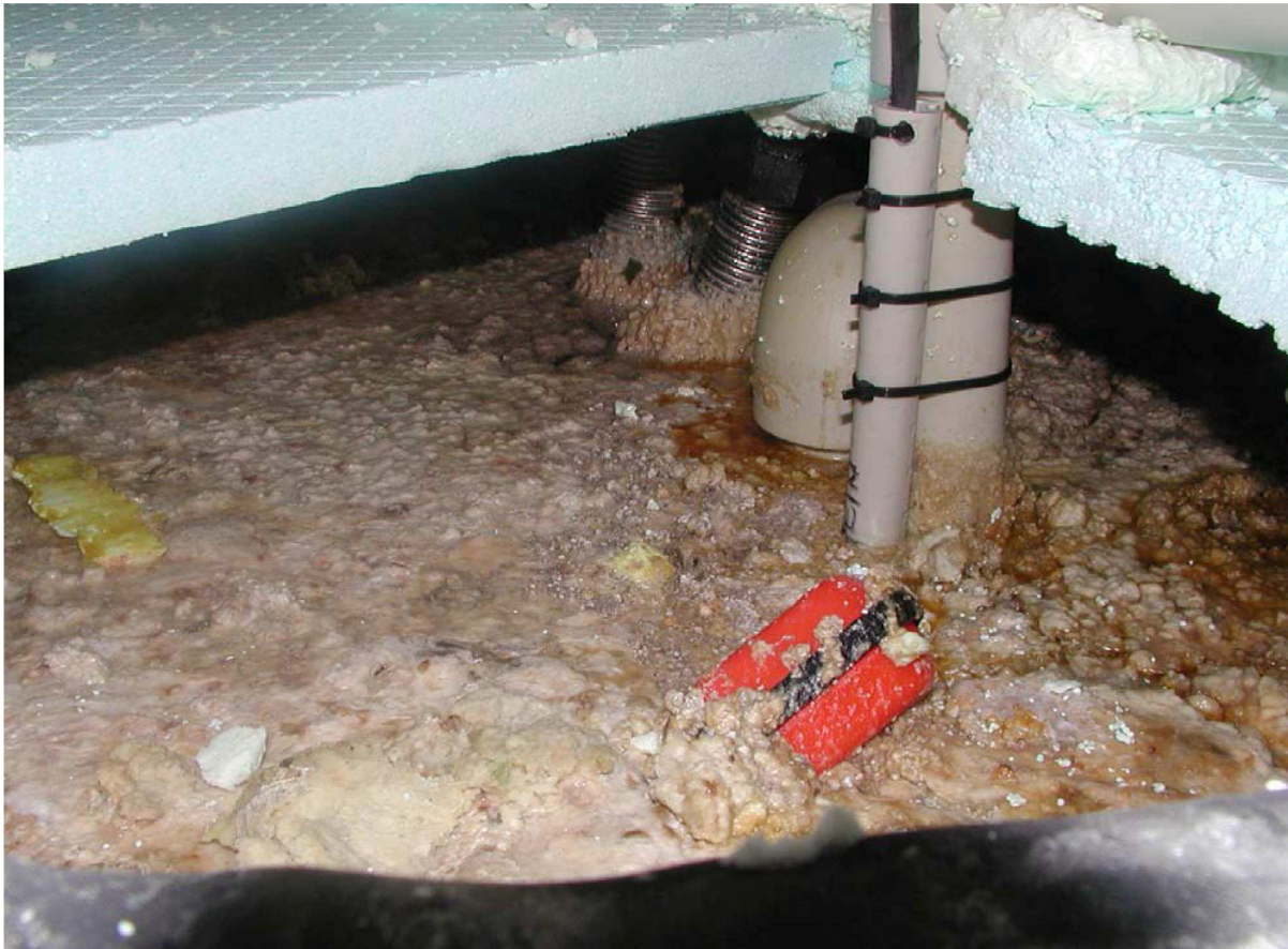
Abb. 3: Verstopfung des Grauwasserbehälters mit Speisefett
