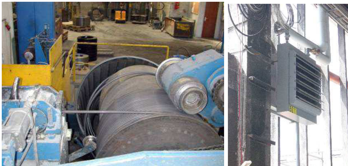
Abbildung 17: Wassergekühlte Ziehmaschinen links und eingesetzte Umluftheizapparate rechts
