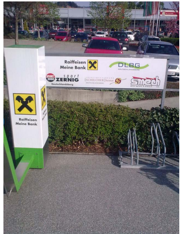
Stromtankstelle in der Erneuerungszone Deutschlandsberg Mitte
