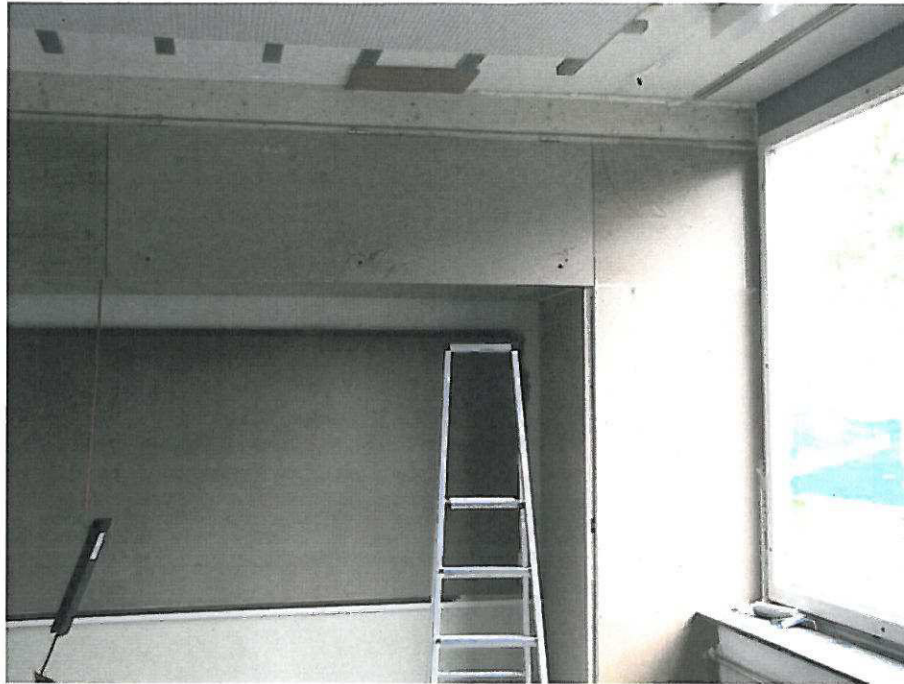
Foto 2: Einbausituation der Lüftungsanlage in der Musterklasse VS Alberschwende (Einhausung; GK-Platte 12 mm, Holzwerkstoffplatte 19 mm).
