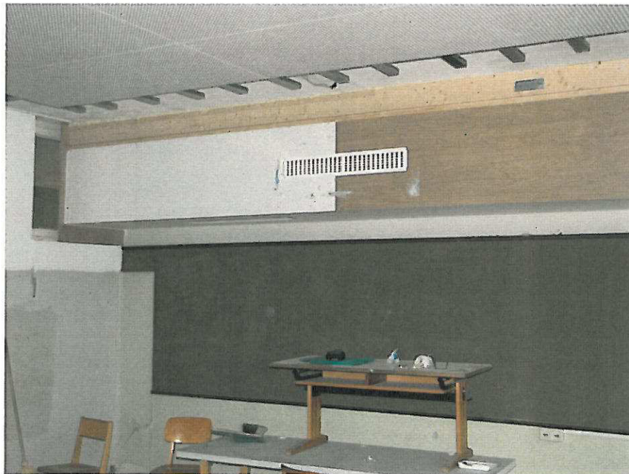
Foto 3: Einbausituation der Lüftungsanlage in der Musterklasse VS Alberschwende (Lüftungsauslass).
