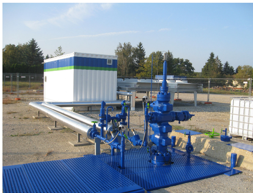
Abbildung 7: Geothermiecontainer, Eruptivkreuz und Rückkühler
