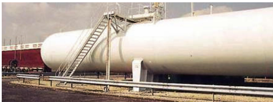
Abbildung 35: Demonstrationsanlage Adsorptiver Speicher (Quelle: Advantica Group)
