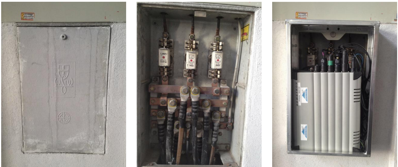
Abbildung 13: Trennanschlusskasten geschlossen / offen / mit Messgerät
