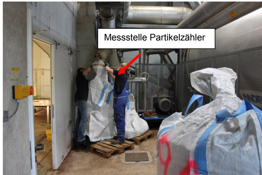
Abbildung 7: Big Bag Abfüllstelle, daneben Staub-Emissionsmessung
