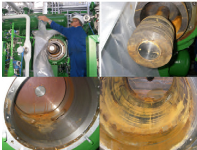
Abbildung 30: Rostbildung in einem Kolbenverdichter
