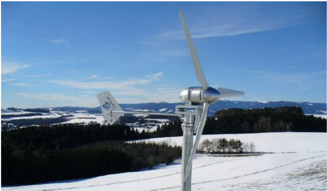
Abbildung 6: Kleinwindkraftanlage Windsolar mit einer Nennleistung von 1,5 kW
