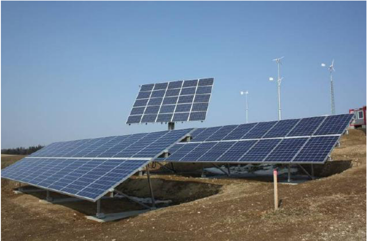
Abbildung 5: PV-Anlage (im Vordergrund 10 kW fix aufgeständert und im Hintergrund 5 kW nachgeführt)
