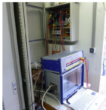
Abbildung 16: Messaufbau in der Funkrepeaterstation Plabutsch
