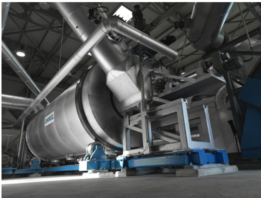
Abbildung 2 ACB Reaktor kurz nach Inbetriebnahme
