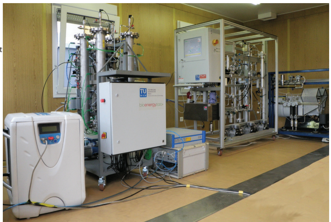
Abb. 1: Versuchsanlage des Polygeneration Projekts am Gelände des Biomassekraftwerkes Oberwart
