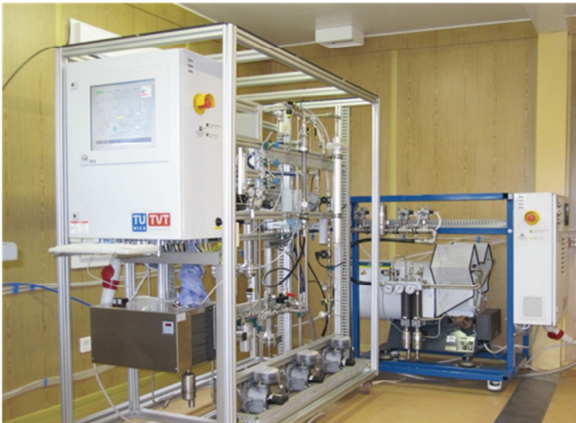
Abbildung 5: Membranversuchsstand am Standort Oberwart während des Aufbaus der Versuchskette Juli 2011 (Konlechner, Aufbereitung von Wasserstoff aus der Biomassevergasung mittels Membrantechnologie, 2015).
