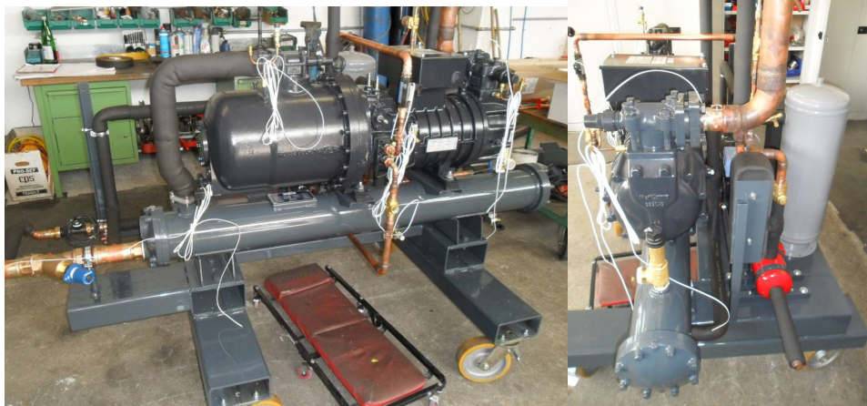
Abbildung 15: Aufbau der Wärmepumpe, Produktionsphase
