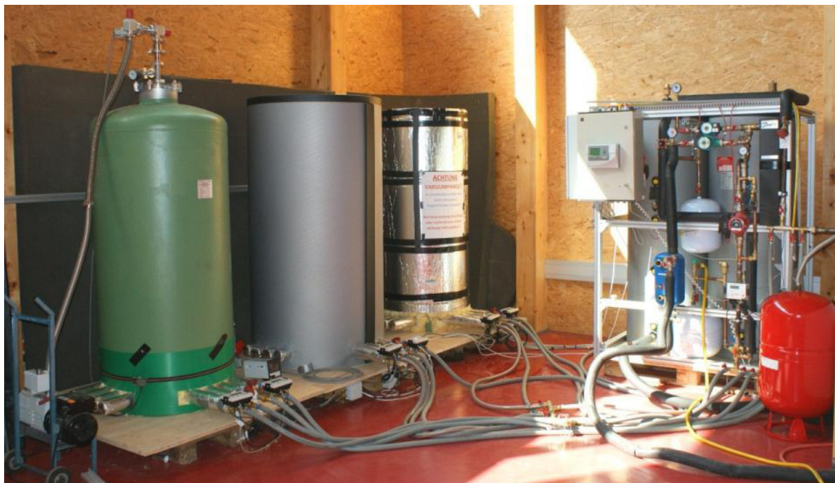
Abbildung 2-9: Speicher am Teststand im Labor der AEE INTEC inklusive Beladestation (Links: Thermoskannenspeicher mit Schüttmaterial im Vakuumspalt, Mitte: Standardspeicher mit PU-Weichschaumdämmung, Rechts: Standardspeicher mit Vakuumisulationspaneelen - VIP's)
