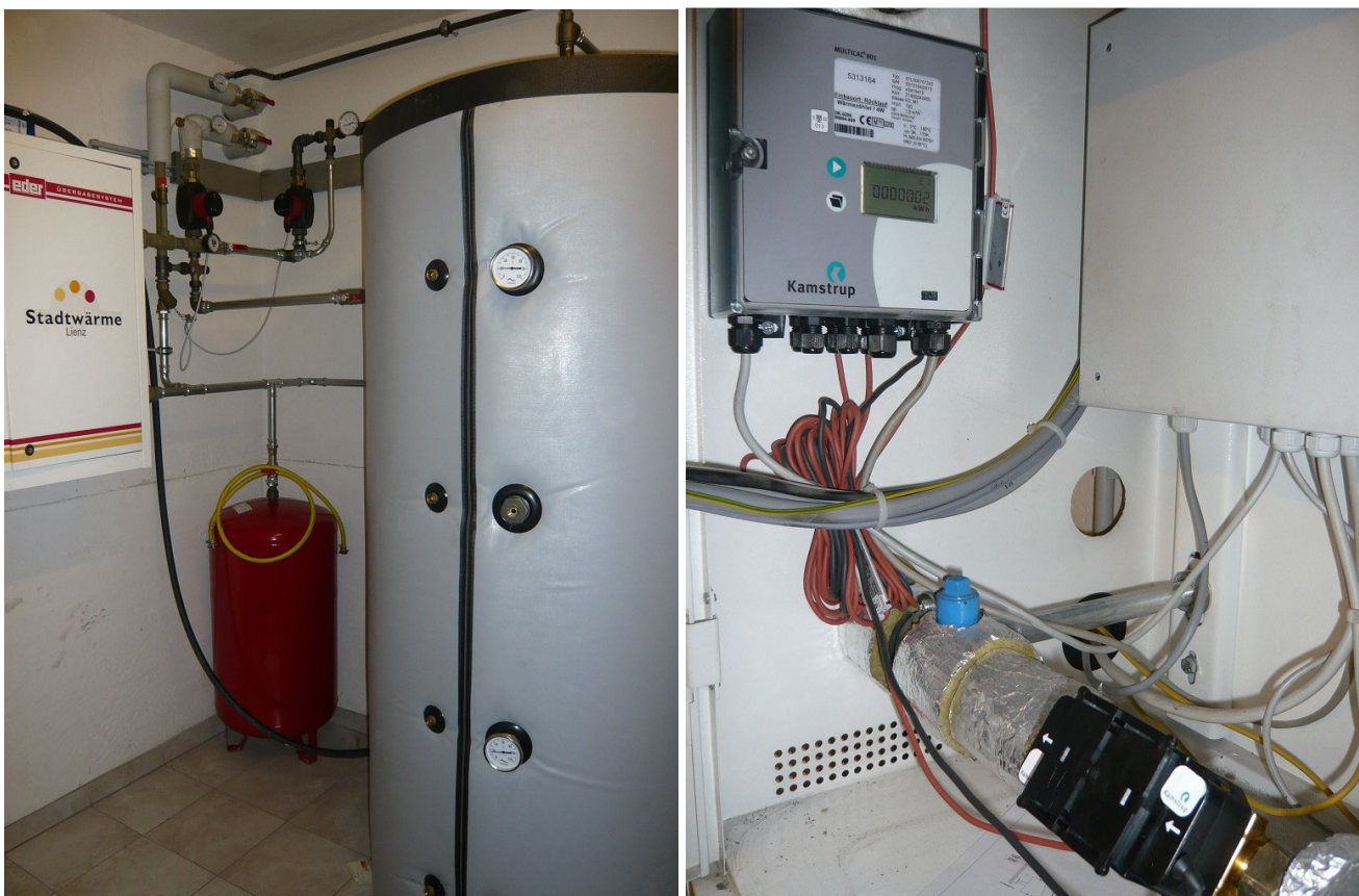
Abbildung 8: Neu errichtete dezentrale Wärmespeicherlösung bei ausgewählten Abnehmer
