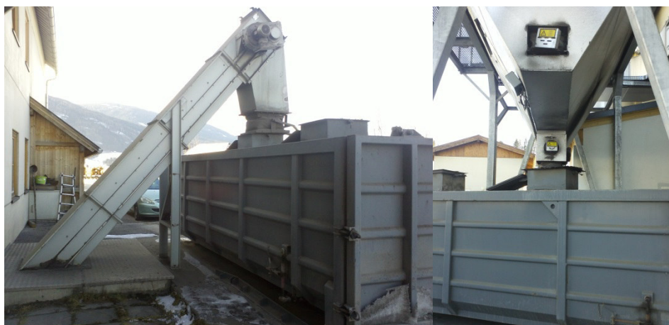
Abbildung 3-8: Asche- und Filteraschesammelcontainer. Während der Bilanzzeiträume wurde die Austragung in einen gesonderten Probenahmebehälter umgeleitet.
