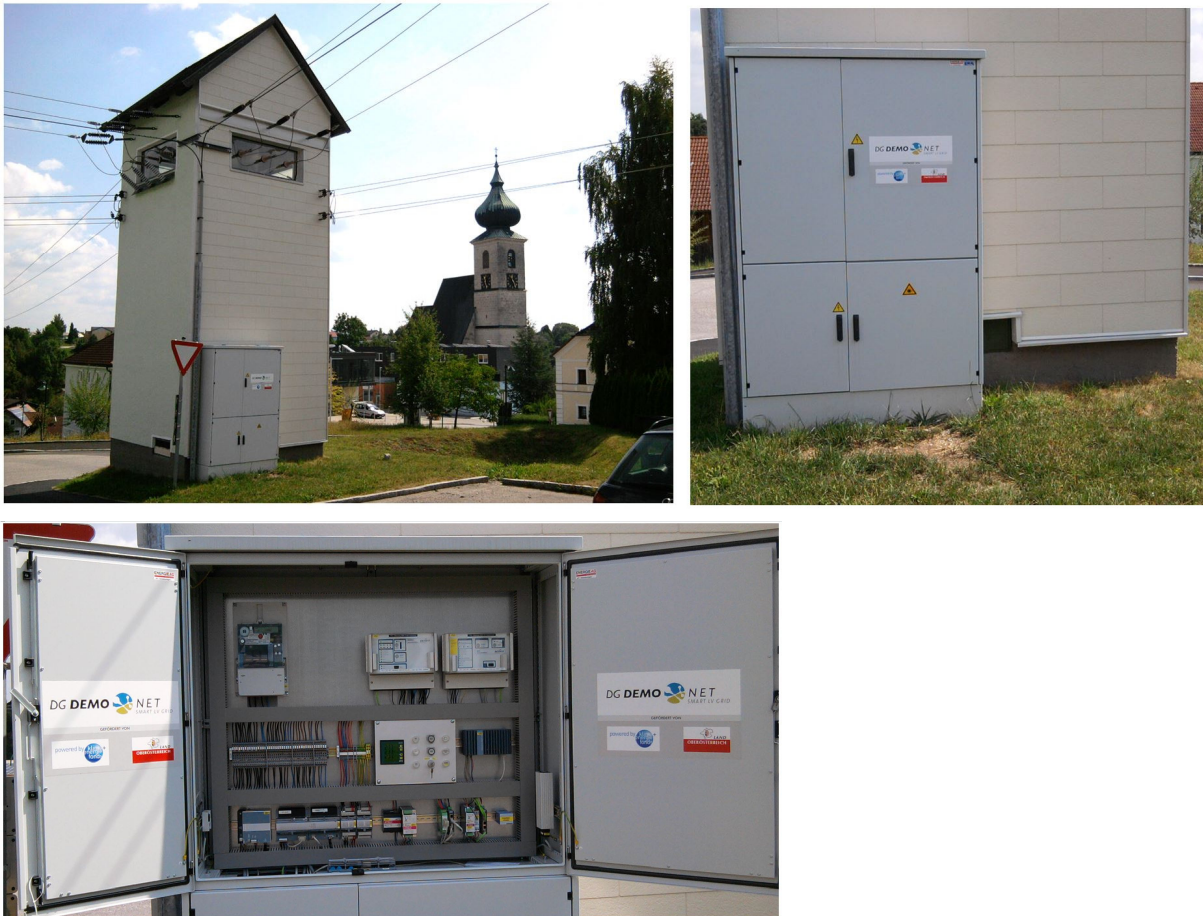
Abbildung 14: Regelbarer Ortsnetztransformator und Steuerschrank Eberstalzell
