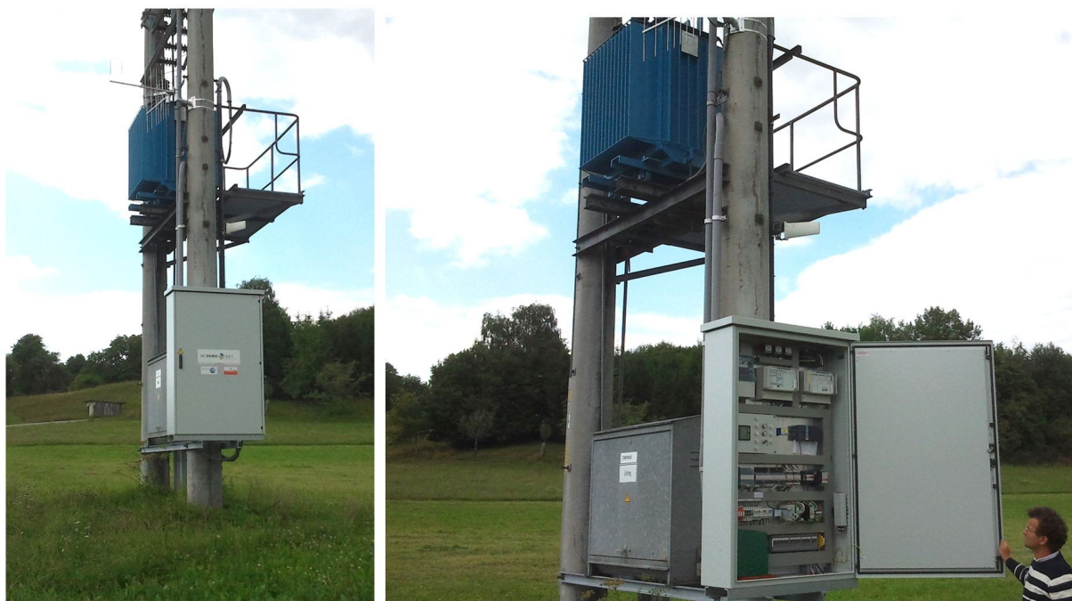
Abbildung 15: Regelbarer Ortsnetztransformator und Steuerschrank Littring
