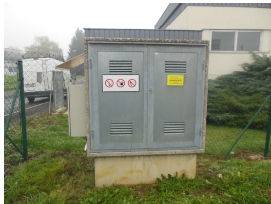
Abbildung 3: Gaszähler in externem Schrank, Quelle: LEA GmbH
