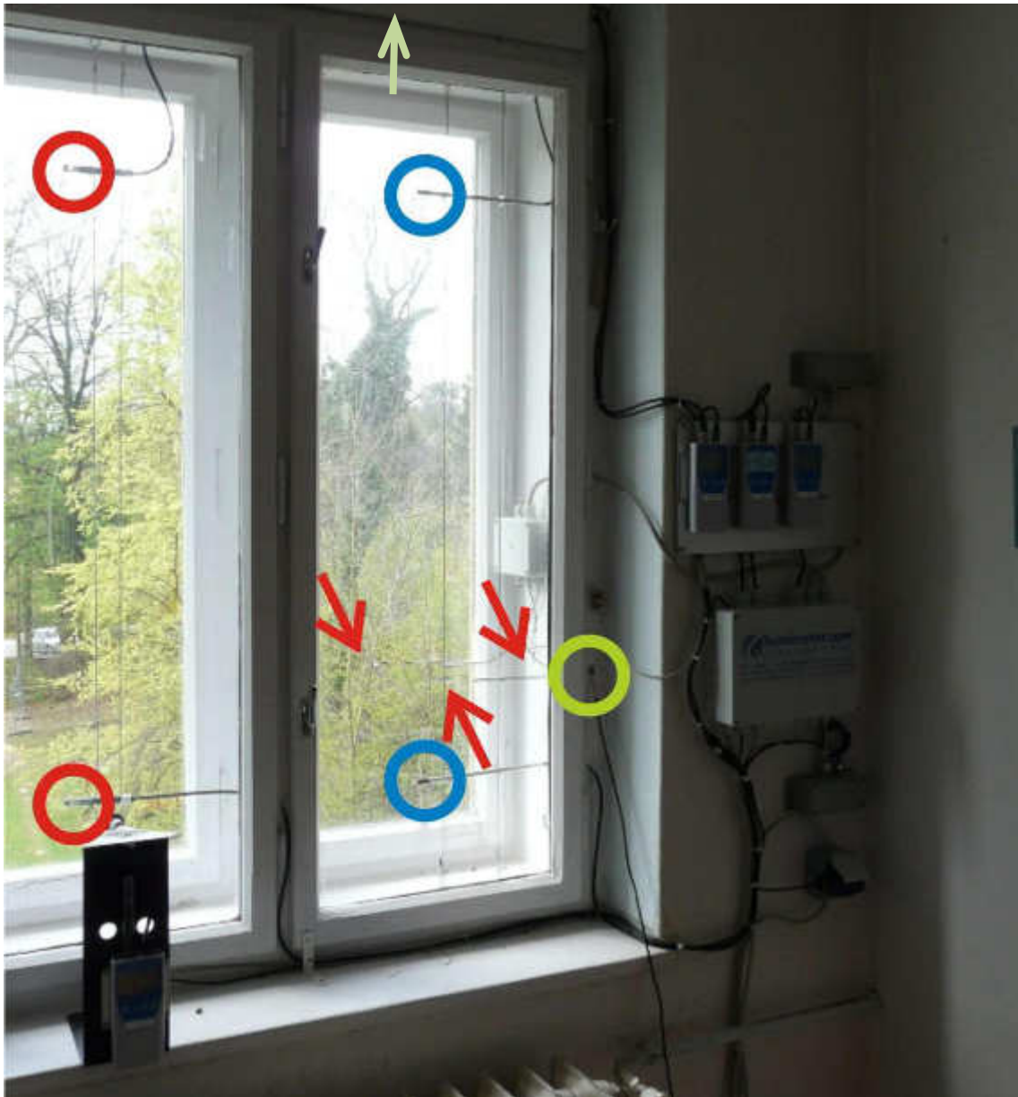
Abb. (38) Sensoren in den Kastenfenstern: oberer und unterer kombinierter Temperatur-/Luftfeuchtefühler im roten Kreis, oberer und unterer Strömungssensor im blauen Kreis, Oberflächentemperaturen an den Scheiben und am Futterholz rote Pfeile, Oberflächentemperatur an der raumseitigen Verkleidung im grünen Kreis
