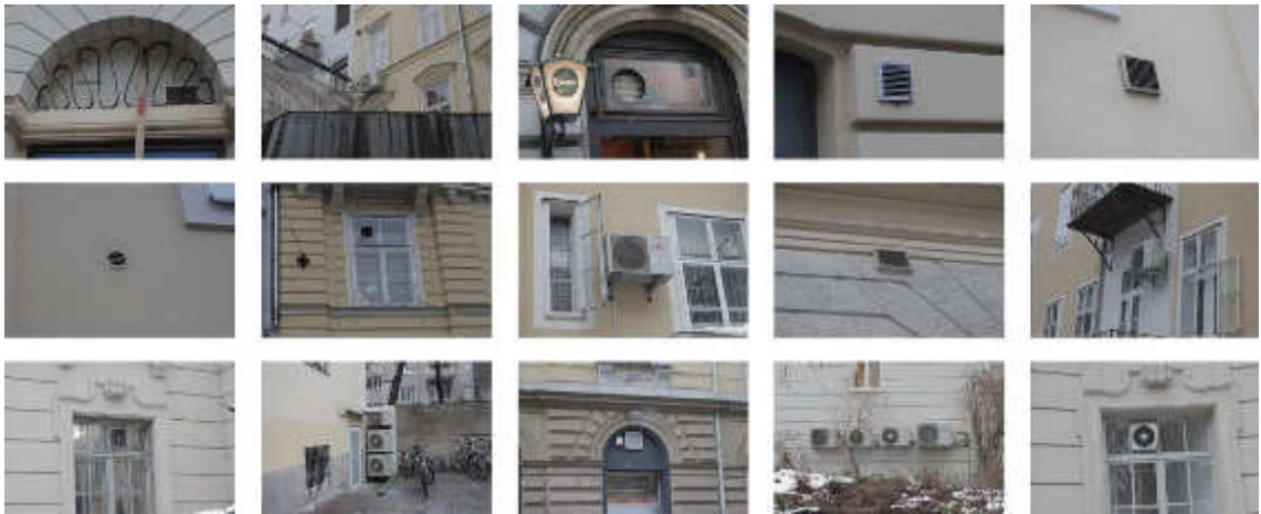
Abb. (355) Unterschiedliche dezentrale Lüftungssysteme bei historischen Gebäuden (IWT (a), 2012)
