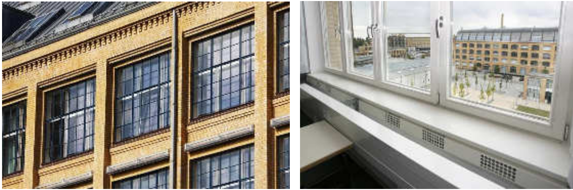
Abb. (137) Darstellung der Fensterlüfter und der Fassade der HWT (AZ/Architekturzeitung, o.A.).
