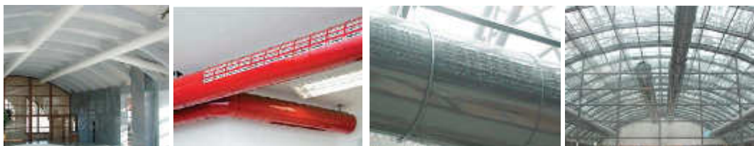
Abb. (357) v.l.n.r. Weißer Lüftungskanal und roter Lüftungskanal (Pichler, 2010, S. 3f) Metallische Oberfläche eines Lüftungskanals im Detail und Ansicht (Pichler, 2010, S. 1)
