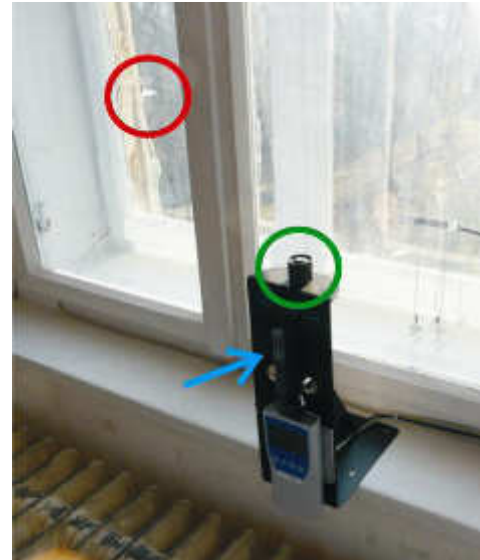
Abb. (39) Pyranometer innen (grüner Kreis) und außen (roter Kreis) sowie Temperatur/Luftfeuchtefühler (blauer Pfeil) über Heizkörper in Raum 2-Ve
