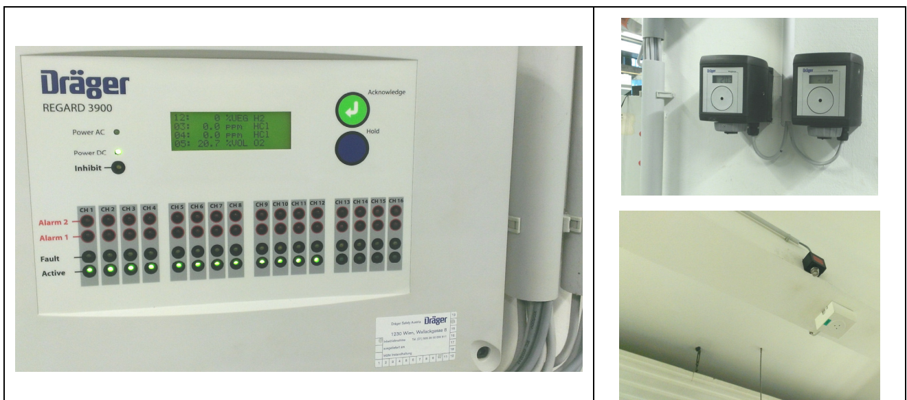
Abbildung 16: Fix installiertes Gaswarnsystem
