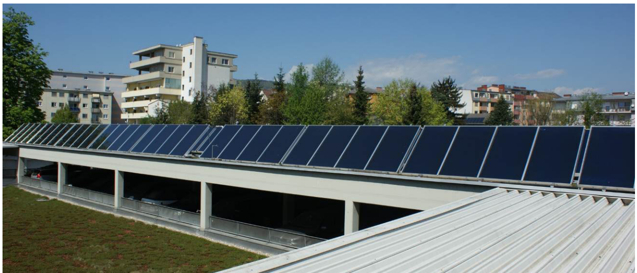
Abbildung 58: Ansicht des Kollektorfelds der Anlage "Elisabethinen". Zu erkennen ist die zentrale Anspeisung mit ungleicher Anzahl Kollektoren auf beiden Seiten.
