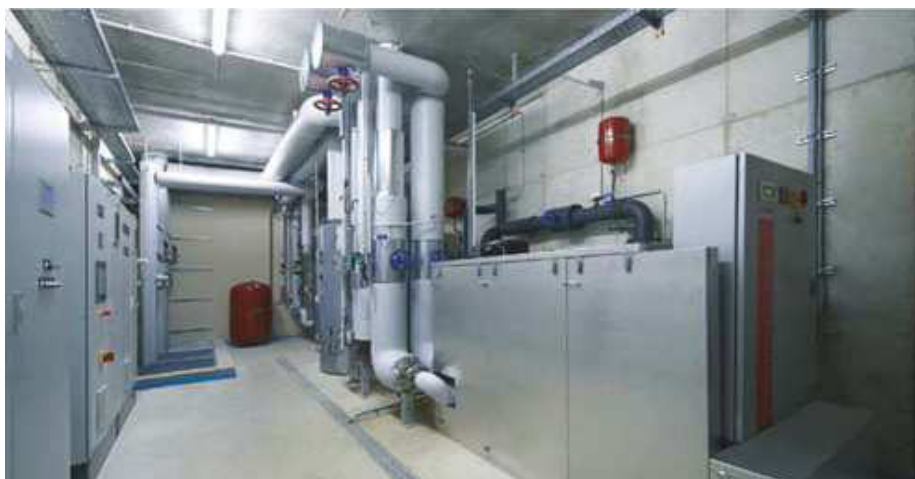
Abb.8: Blick in den Heizraum. Im Vordergrund WP OCHSNER ISWS150ER2 samt kompletter Schallschutzverkleidung.
