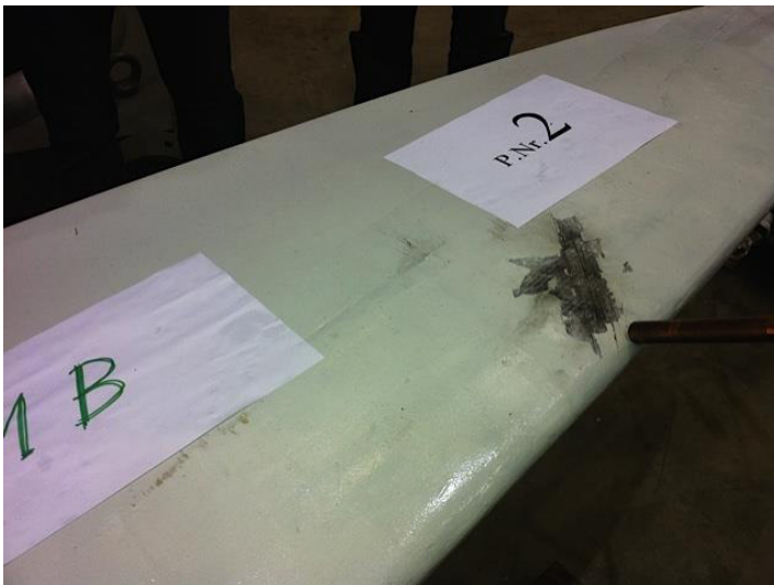
Abbildung 19: Beschädigung der Deckschicht über dem Heizlack von Villinger nach Blitzeintrag
