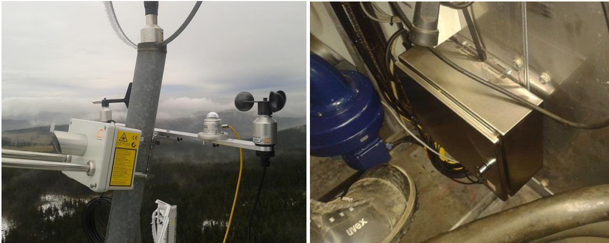
Abbildung 3: Von WEB bei Sternwind installierte Messanlagen und Sensoren
