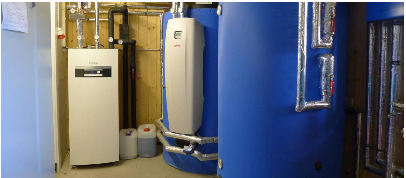
Abbildung 41: Heizraum mit Wärmepumpe und zwei Pufferspeichern
