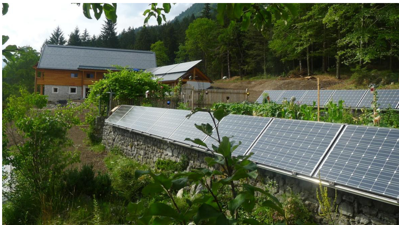
Abbildung 65: Anlage 1 im Hintergrund, Anlage 3 im Vordergrund
