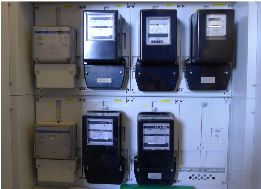
Abbildung 52: Im E-Hauptverteiler-Schrank wurden für sämtliche Wohnungen, für den Seminarraum, für die Allgemein-Bereiche, für den PV-Ertrag, sowie für den Gesamtstromverbrauch eigene Messzähler installiert, sodass eventuelle Schwachstellen der Energieeffizienz ersichtlich gemacht werden. Die Zählerstände werden laufend aufgezeichnet.
