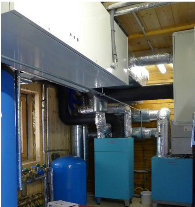
Abbildung 45: Technikraum mit den 3 Lüftungsgeräten
