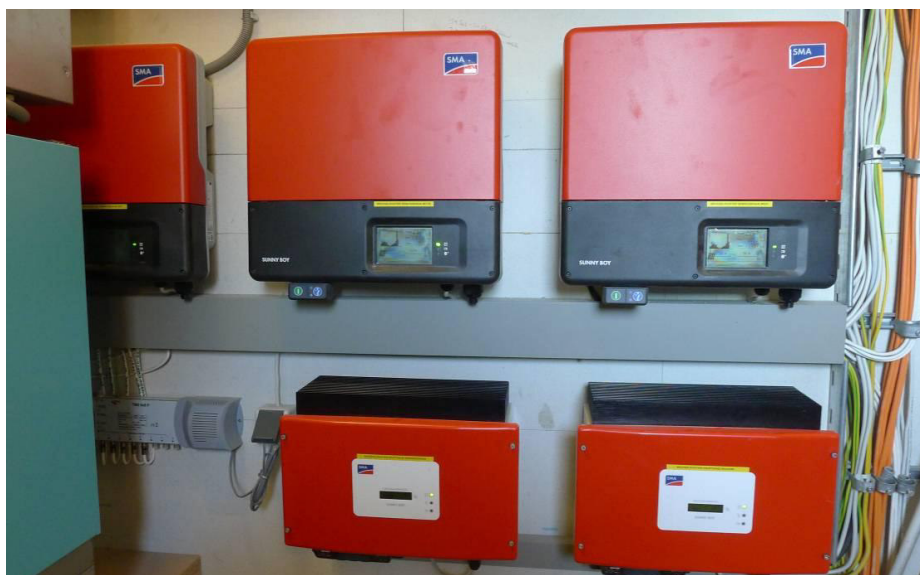
Abbildung 68: Foto der drei Wechselrichter von Anlage 1 (oben) sowie der beiden Wechselrichter von Anlage 2
