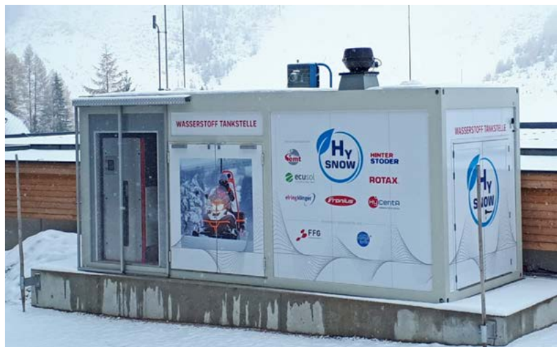
Links: Photovoltaikanlage, rechts: Wasserstoffproduktionsanlage inklusive Betankungszapfsäule, Fotos: BRP-Rotax GmbH & Co KG
