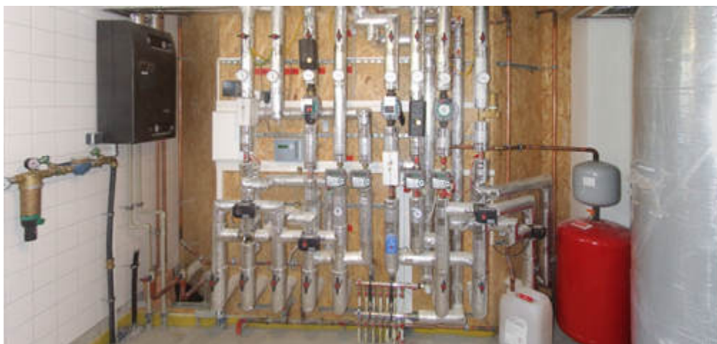
Abbildung 62: Technikraum des Solarhauses Wieder (Bildquelle: AEE INTEC)
