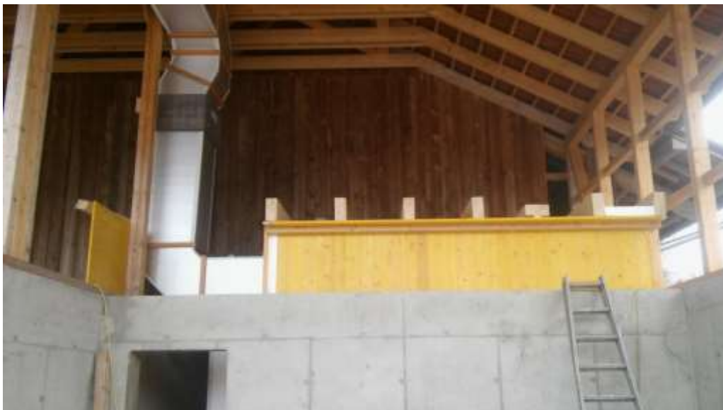
Abbildung 14: Luftkanal in Richtung Steinspeicher/Mischkammer – Fortsetzung von Abbildung 13 (Quelle: Bauherr)
