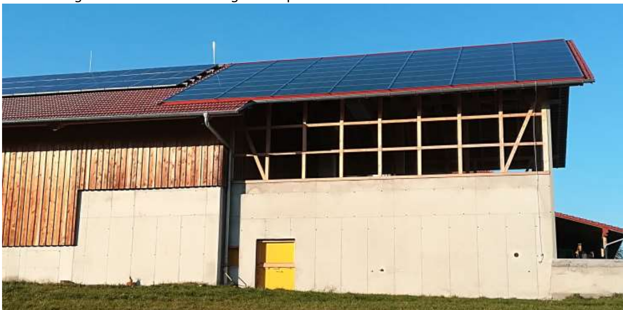
Abbildung 12: Luftkollektoranlage auf dem Dach der Trocknungshalle (Quelle: Bauherr)
