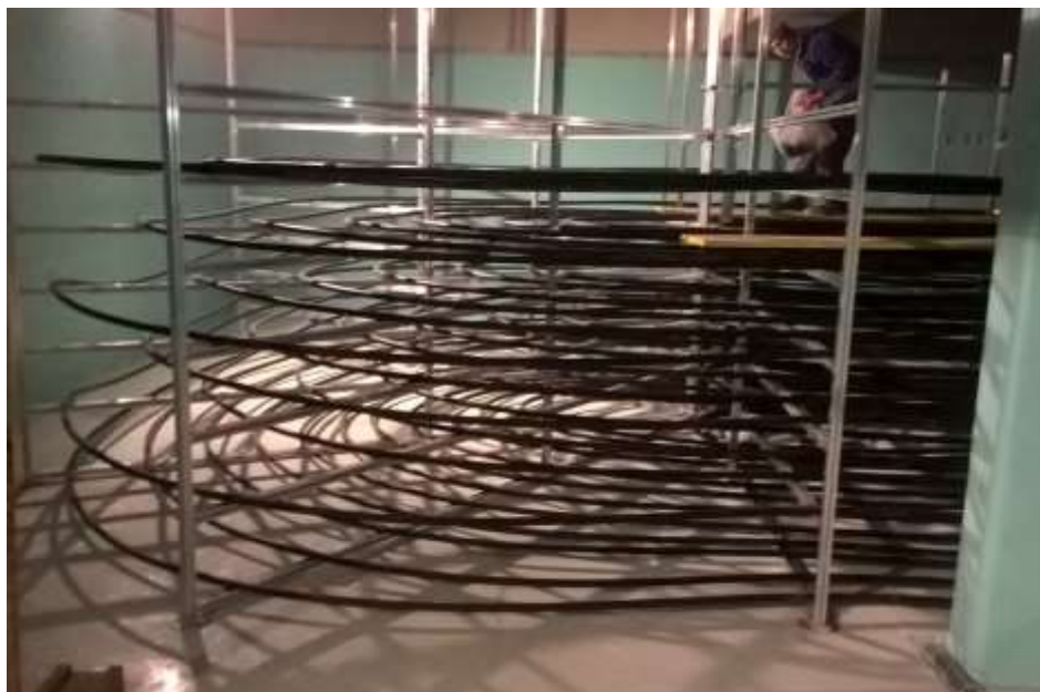
Abbildung 7: Wärmetauscher im Eisspeicher bei Umsetzung der Anlage Audio Tuning Vertriebs GmbH (Quelle: Ökoplan Energiedienstleistungen GmbH)
