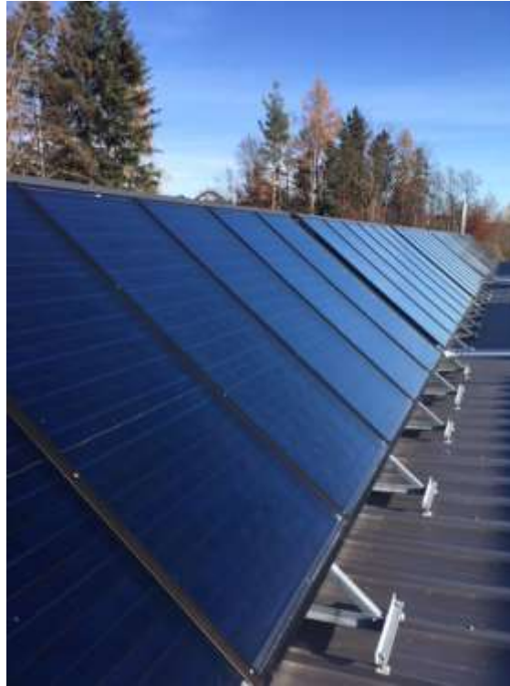
Abbildung 34: Solaranlage auf dem Dach der Produktionshalle der Anlage Weizer Schafbauern (Quelle: Betreiber).
