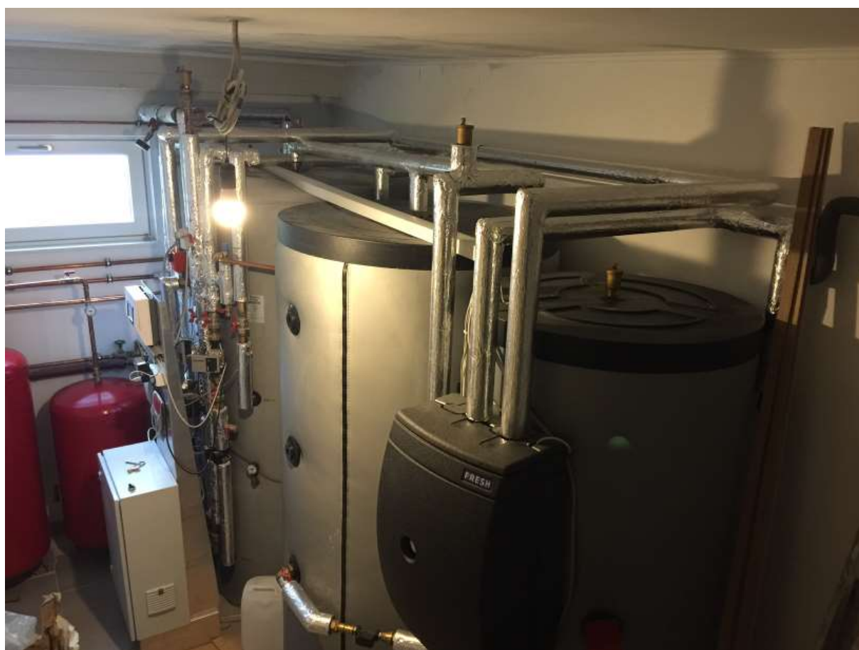
Abbildung 6: Technikraum des Solarhauses Fasching (Quelle: Bauherr)
